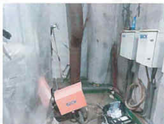
2#排气筒 DA002 (Q2) 有组织排放废气
